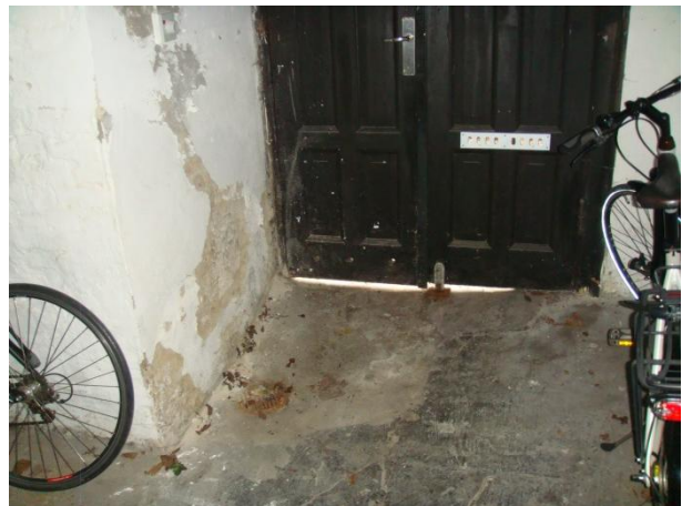
Afskallende puds i kældergennemgang
