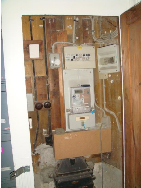
Forsyningstavle i opgang 18
