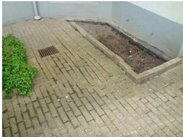
Sætninger af belægning på gårdside
