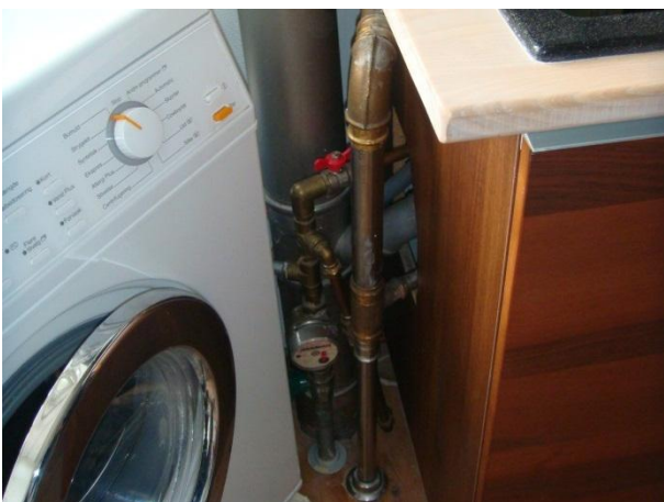
Blandede rør i vandinstallation
